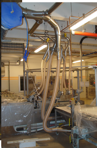
Utsug av stoft och damm i anslutning till produktionslinje
